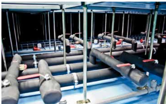
Rozvod chlazení pod podlahou
